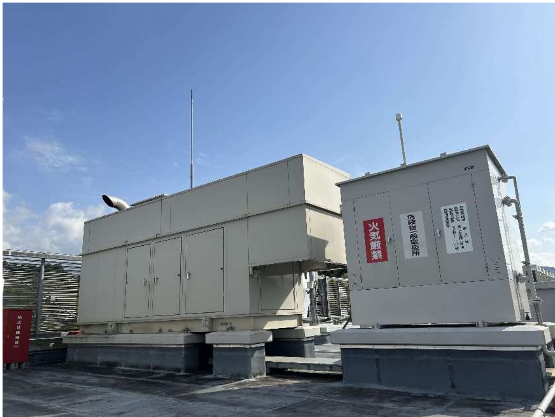
危険物施設 一般取扱所（発電設備）
